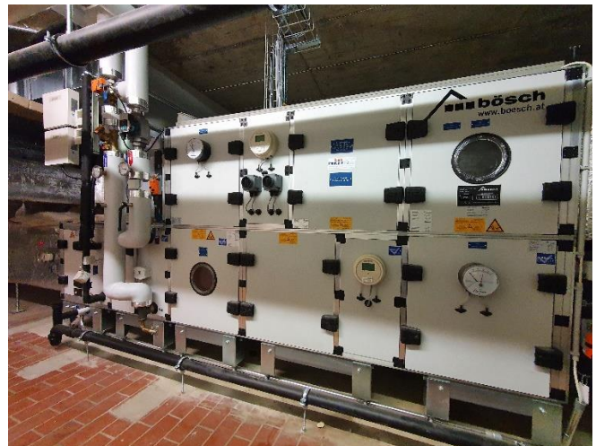
Lüftung und Klimaanlage Geschäftsflächen
